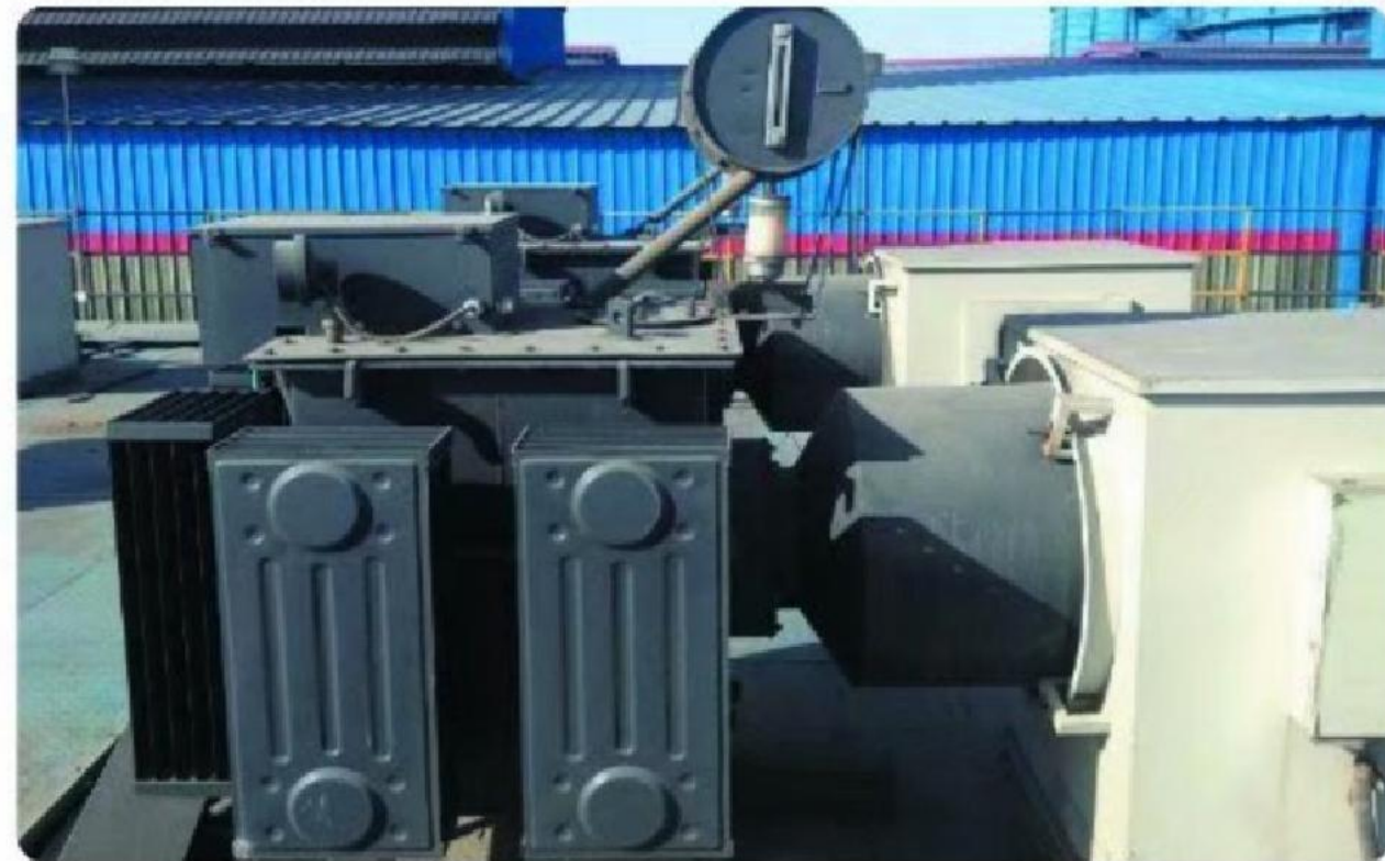
变压器现场使用图
